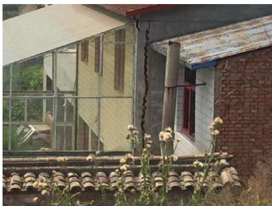
照片 3-2-13 搬迁前有裂缝的房屋
