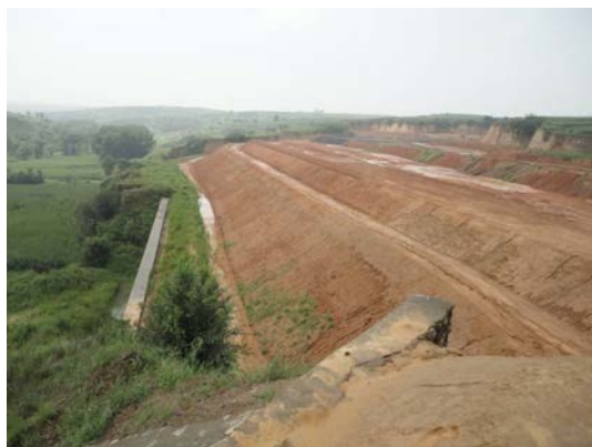
照片 3-2-27 矸石场拦渣坝
