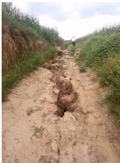
照片 3-2-2 地裂缝（现场调查）
