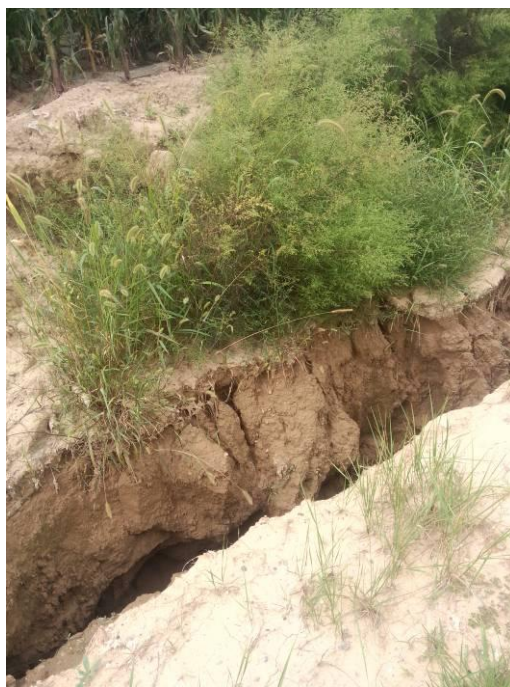
照片 3-2-6 地面塌陷（现场调查）
