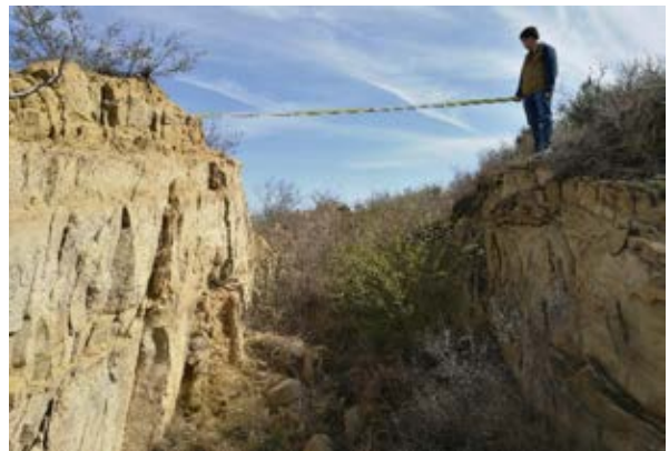
d) 前缘超宽裂缝
