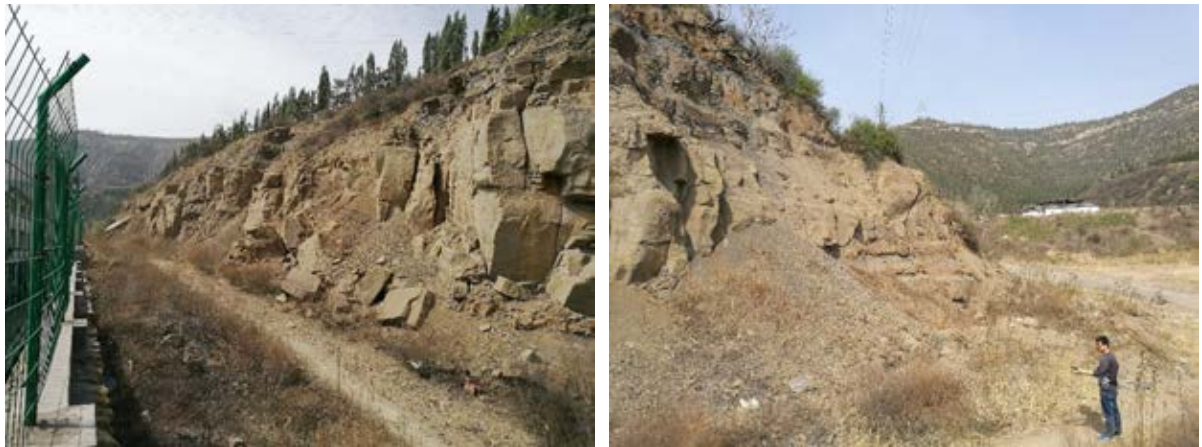
图3-18 B4 崩塌点现状
