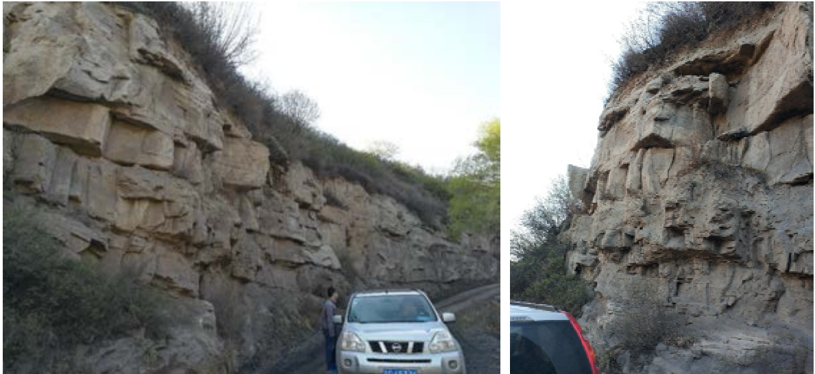
图3-21 B7 崩塌点现状
