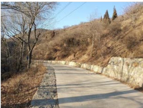
c) 崩塌区 C 段
