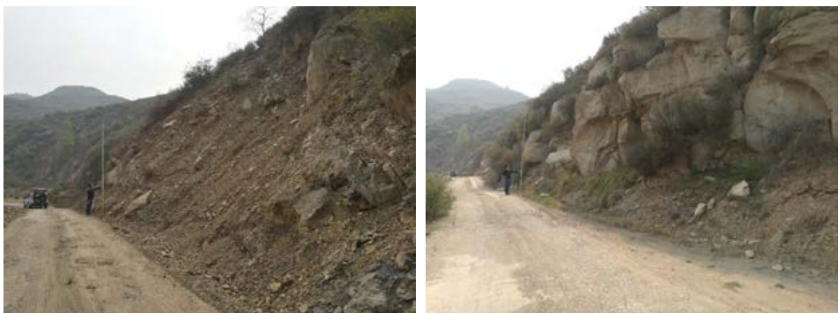
a) 南段崩塌点
