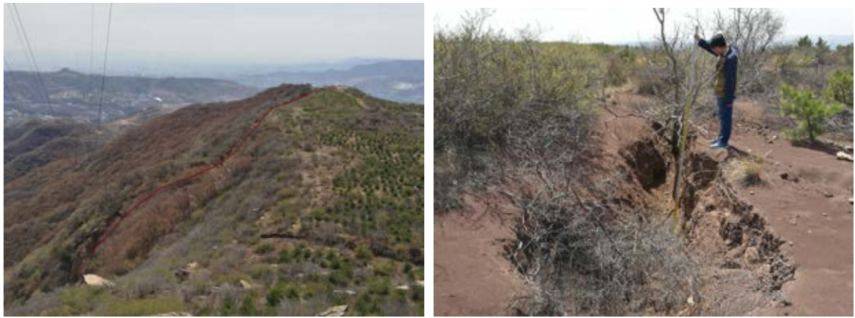
a) 主裂缝全貌（镜向东南）
