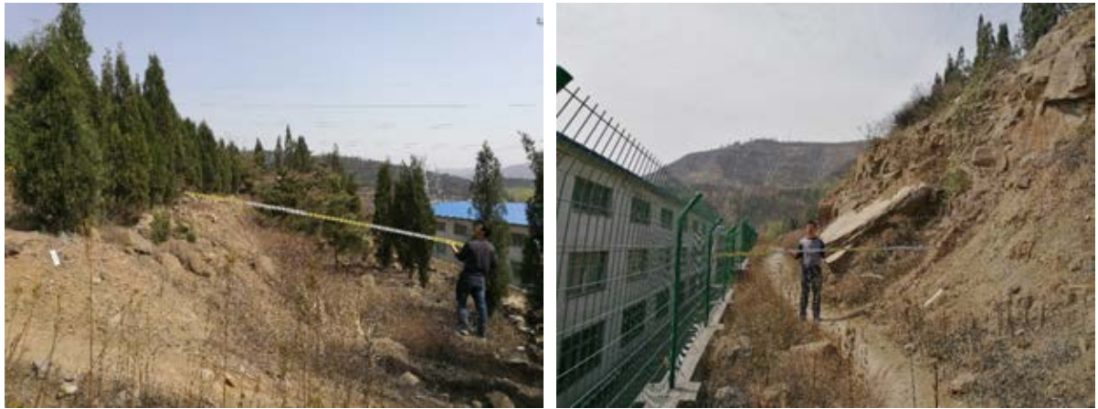
图3-17 B4 崩塌点已采取的防护措施
