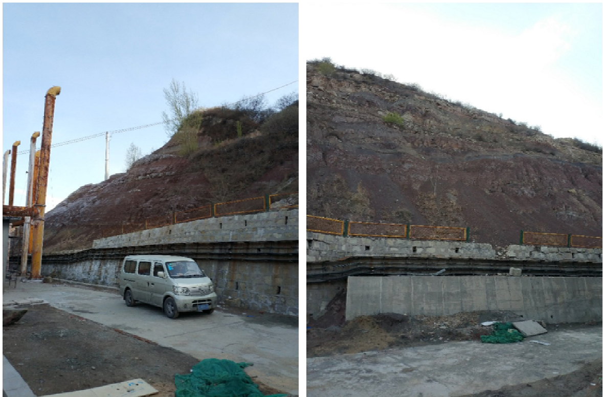
图3-24 B10 崩塌点现状
