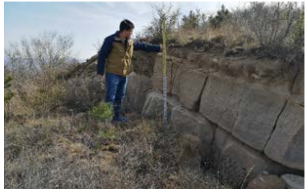
b) 后缘裂缝错台
