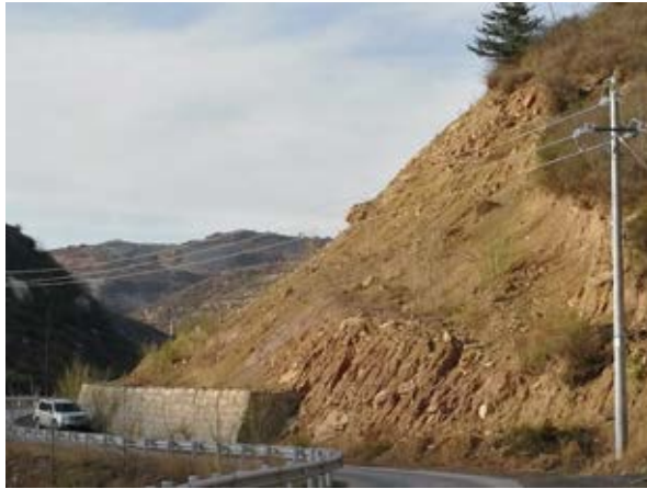
a) 小型滑坡挡墙
