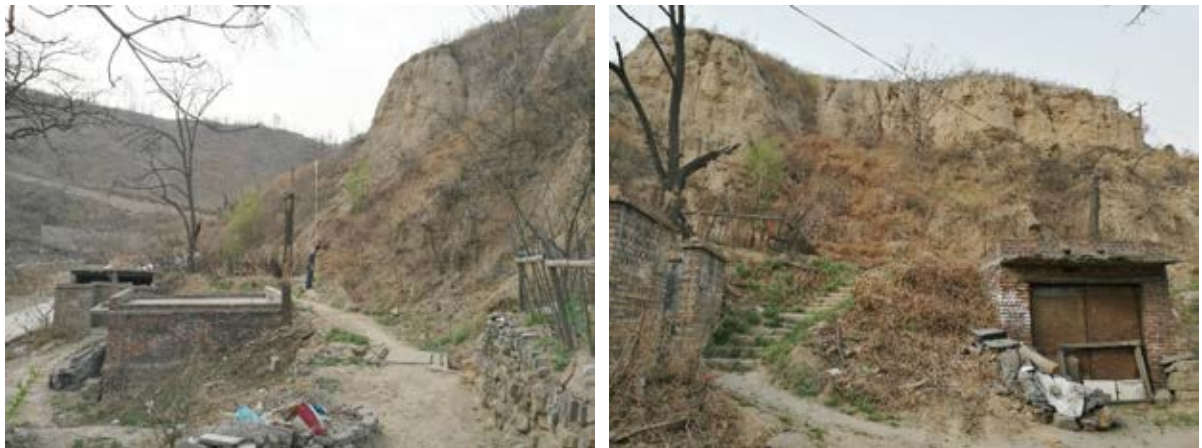
图3-19 B5 半坡村黄土崩塌点现状
