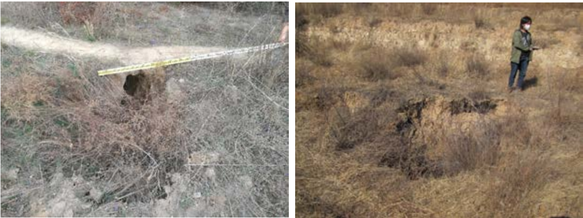
a) T3 塌陷坑
