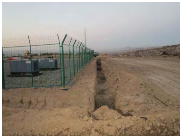
图 2-25 大吉 5-6 井区大吉 4-6 井场截水沟
