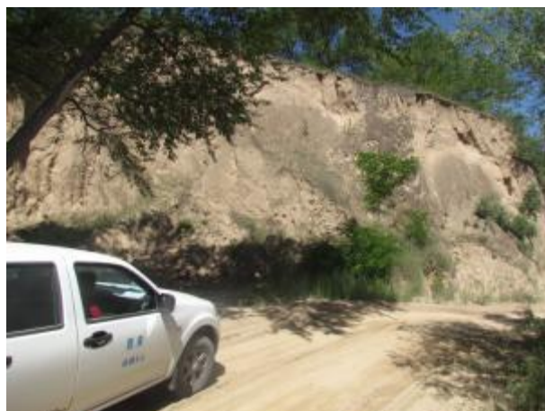
照片 3.2-7 金坪 40 井场道路旁高陡边坡
