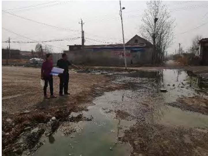
照片 3-6 前街村地面塌陷（临时积水，一采区）
