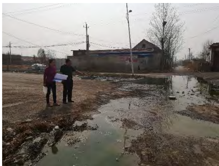
照片 3-14 前街村地面塌陷（临时积水，一采区）
