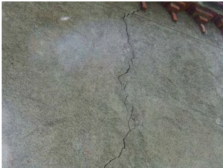
照片 3-13 姚店村内民房开裂
