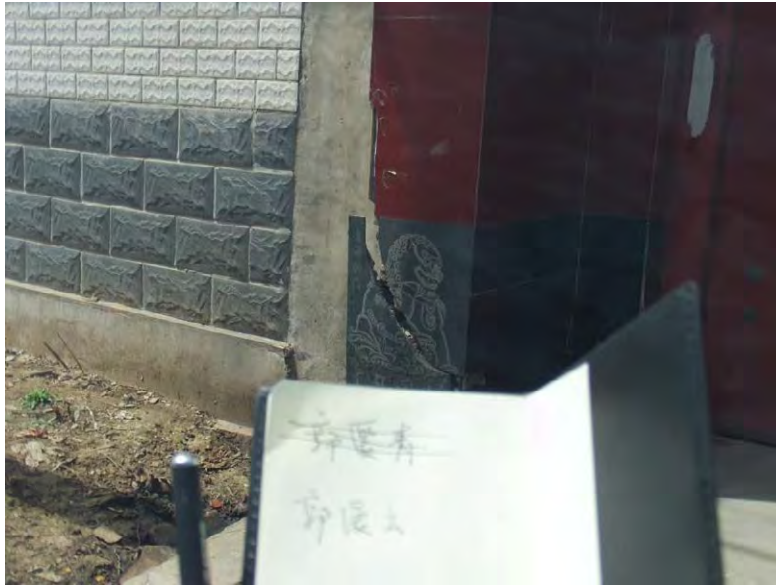
照片 3-12 司家村内民房开裂
