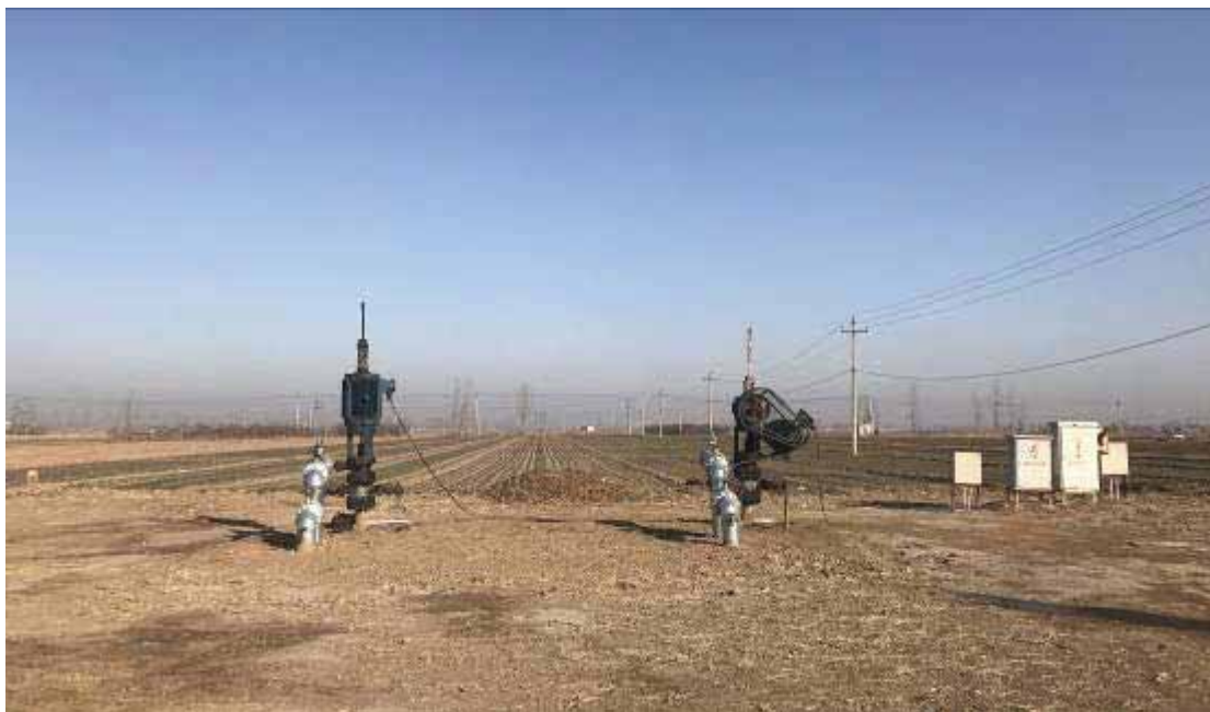
照片 1-3 螺杆泵生产油井（镜向西）
