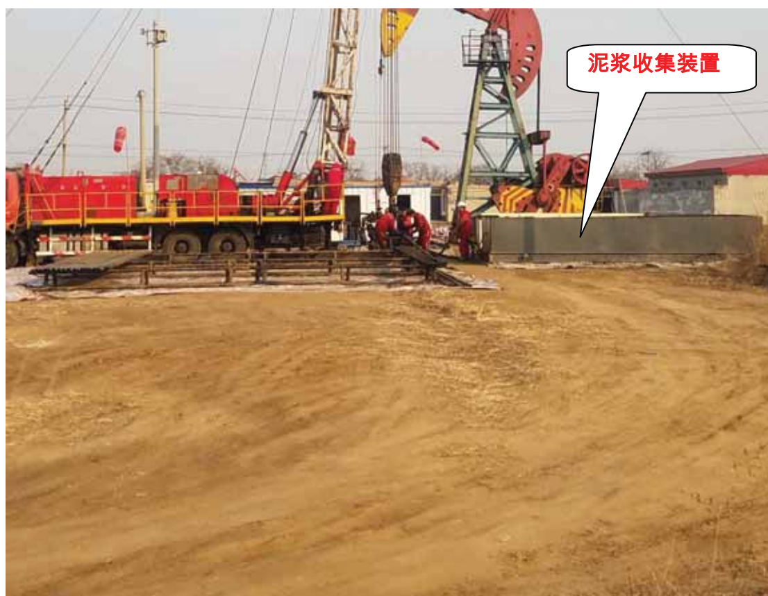
照片 2-7 钻井泥浆收集装置
