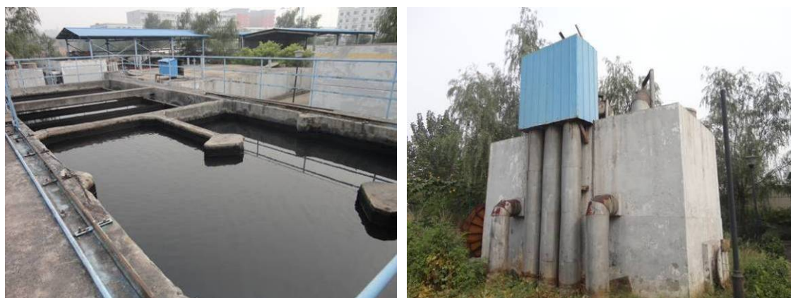
图 1-11 矿井污水处理设备
