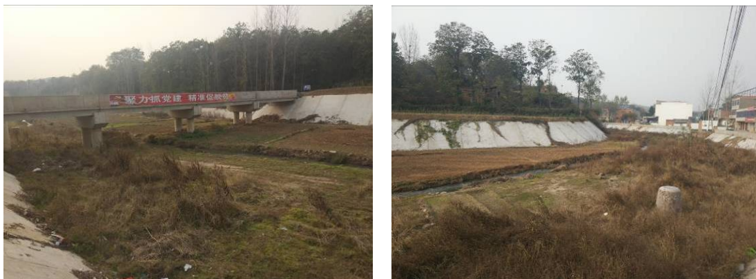
图 2-3 已被开垦为农田的水库渠道
