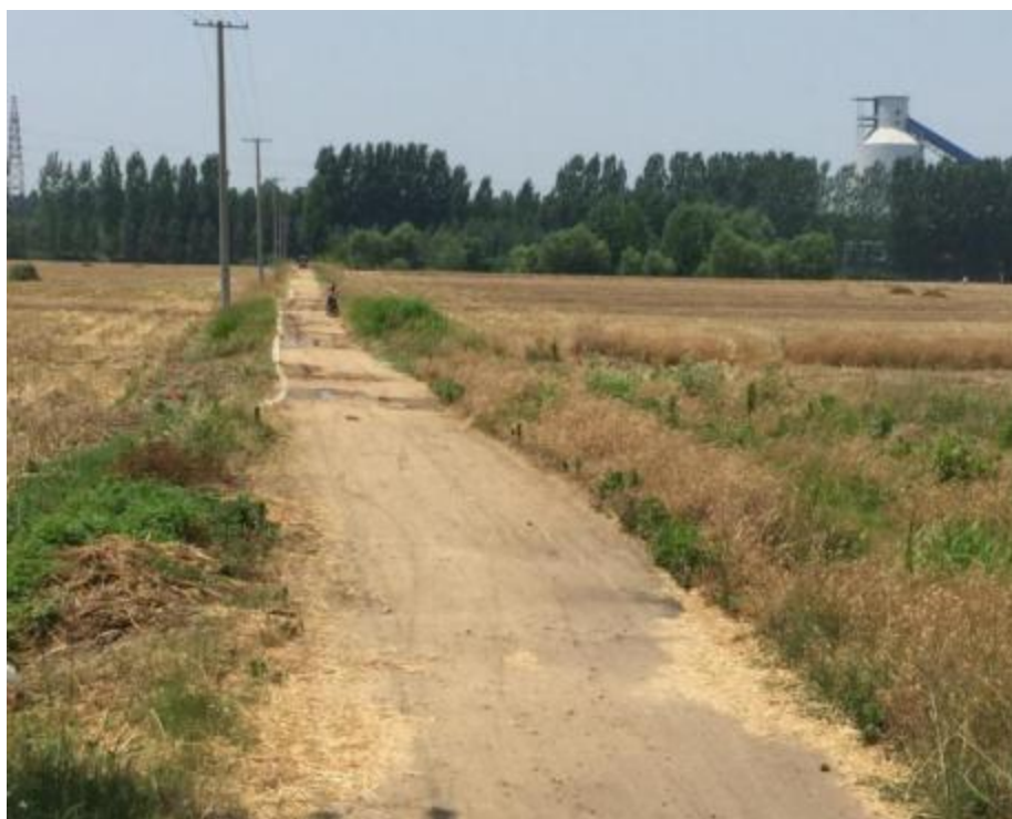
图 3-60 项目区道路损坏情况
