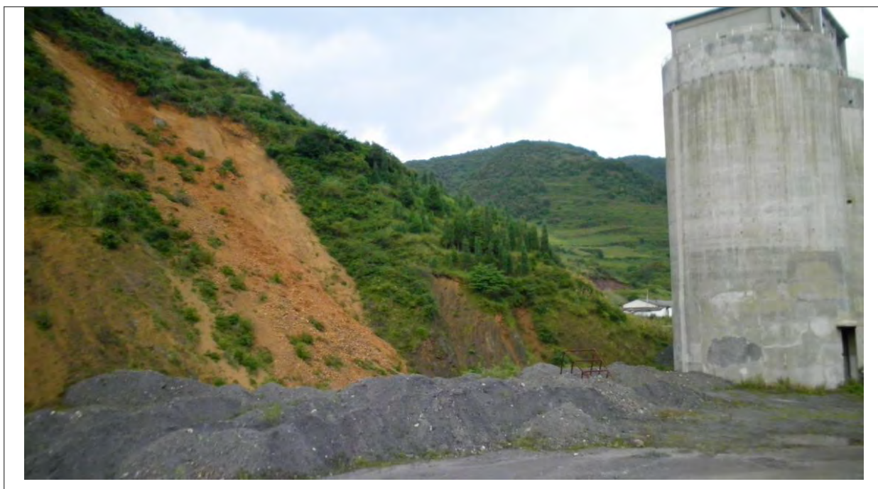
照片 3.2-6 BW 3 不稳定斜坡
